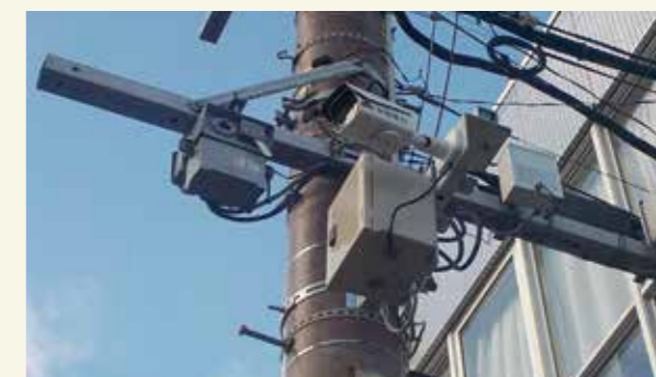
防犯カメラの設置
