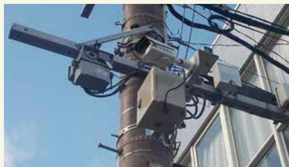
防犯カメラの設置
