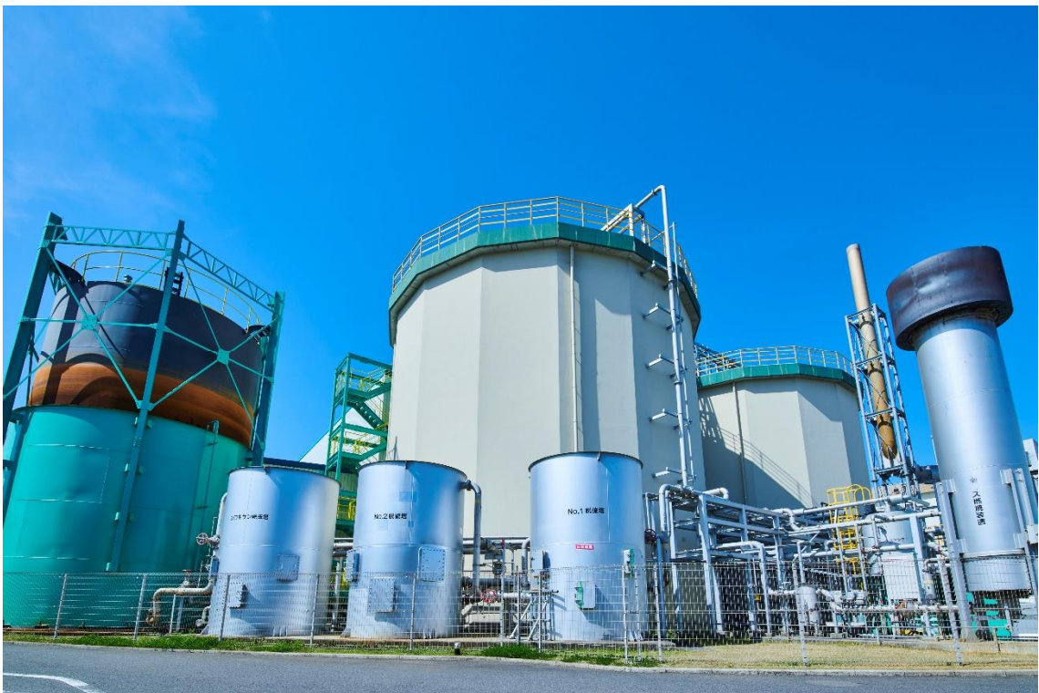
ガスホルダ（左端）とメタン発酵槽（中央）
