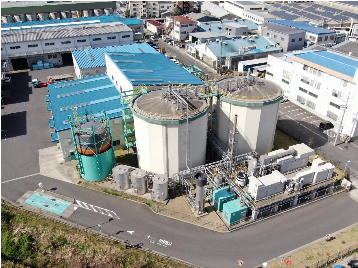
横根バイオガス発電施設（上空から）
