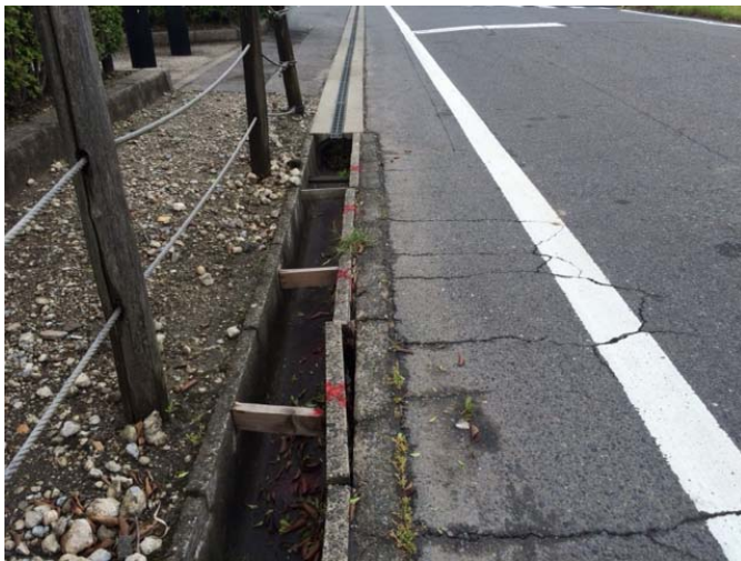
写真：老朽化して破損した側溝
