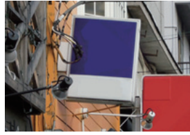
上部構造全体の傾斜、 ぐらつき
