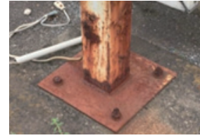
鉄骨のさび・ 塗装の老朽化
