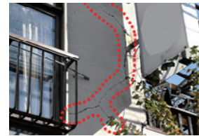
取付対象部（柱・壁・スラブ）・ 取付部周辺の異常
