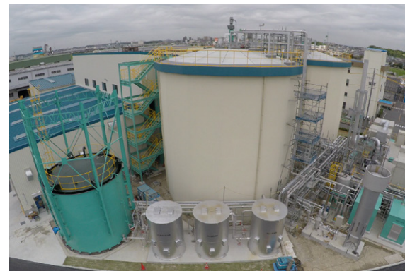
バイオガス発電施設(横根町)
