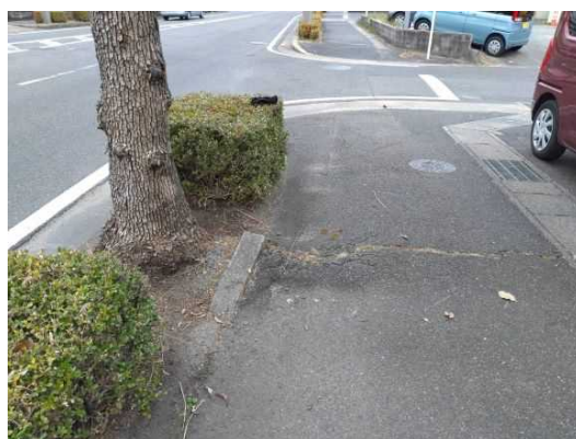
街路樹により根上がりした歩道（大府共和線）
