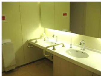
車椅子使用者用洗面台 (バリアフリーの一例)
