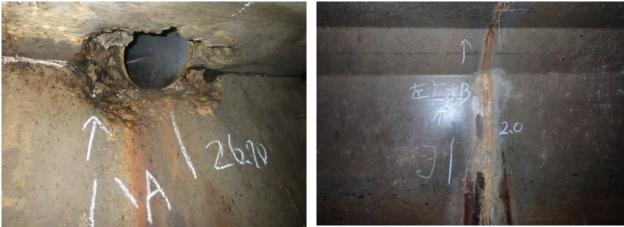
写真修繕が必要な雨水管路 写真左：管路の破損、写真右：浸入水が確認されるもの
