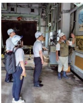
▲市民クラブ (下水道バイオマスエネルギー利活用施設)
